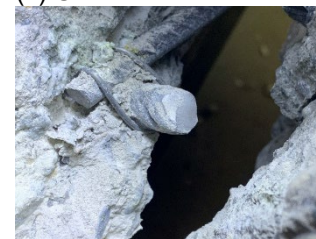
(d) Ermüdungsbruch der Stahlbewehrung.
